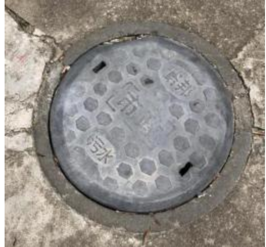
市政污水井盖照片
