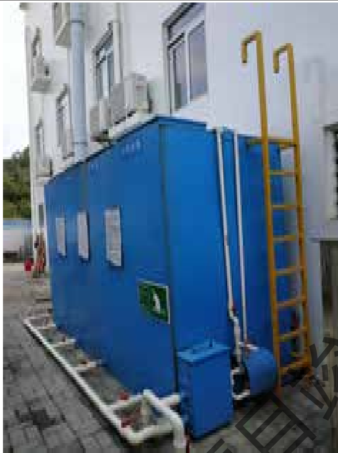
废水处理设施（自建一体化污水处理设施）
