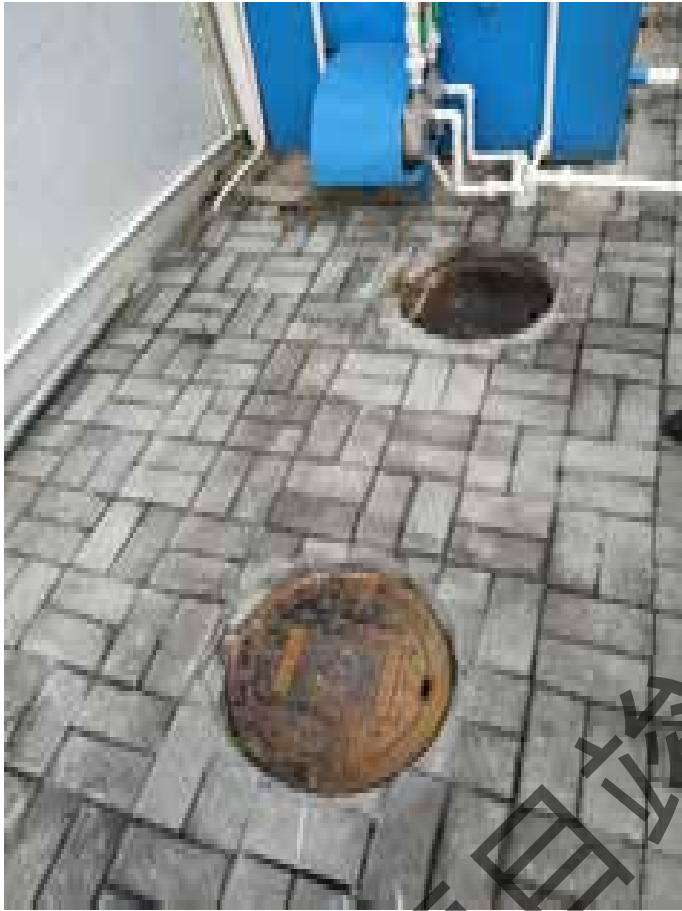
废水处理设施（隔油隔渣池）
