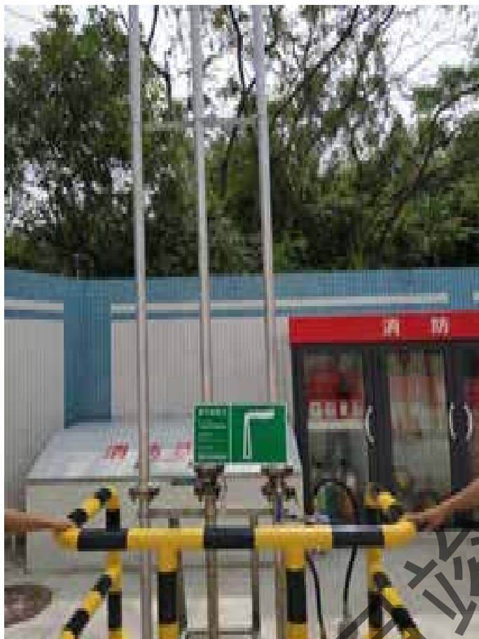
油气处理设施（油气回收装置）
