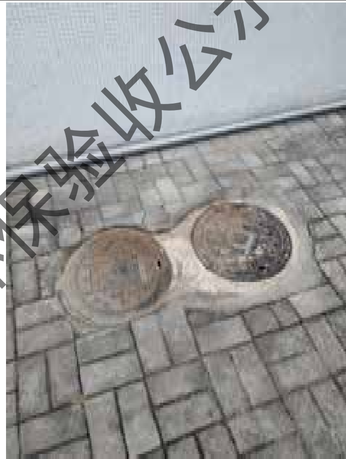
废水处理设施（化粪池）
