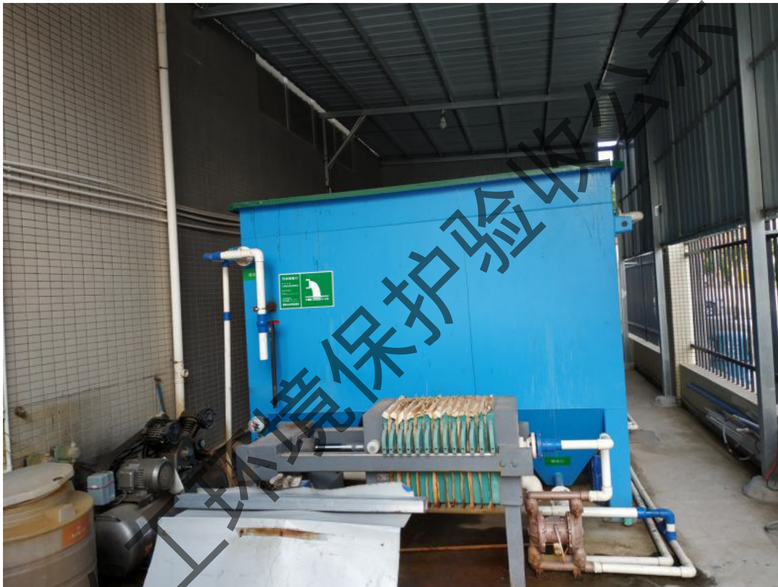
附图 5 废水治理设施
