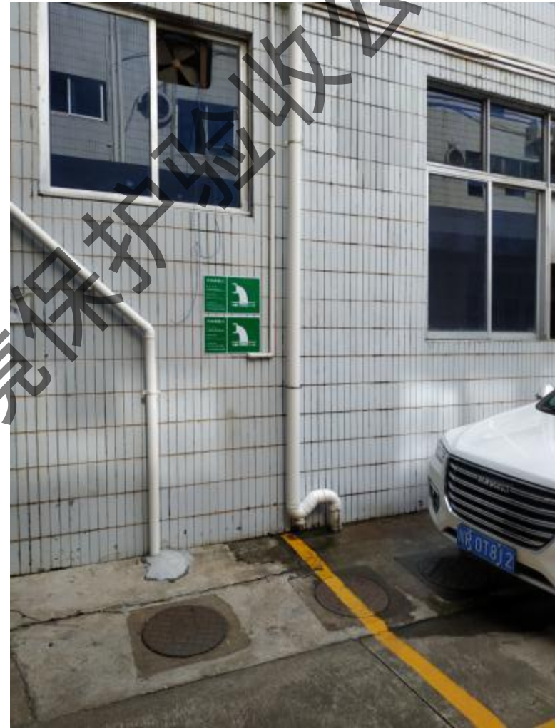
生活污水排放口 水-01
