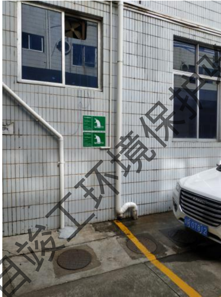
生活污水处理设施（三级化粪池）
