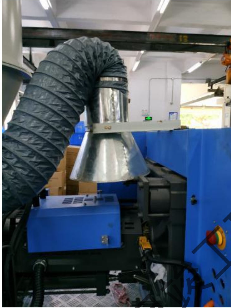
废气收集设施（集气罩）
