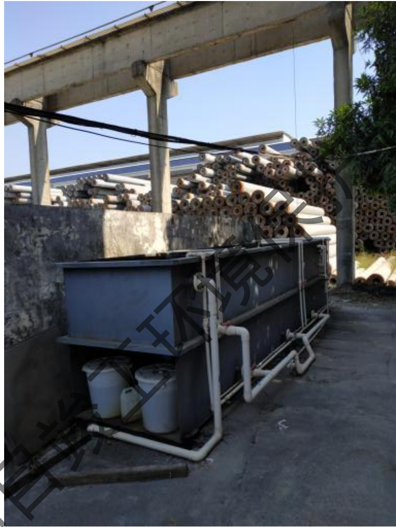
广州市峻兴混凝土有限公司污水处理系统
