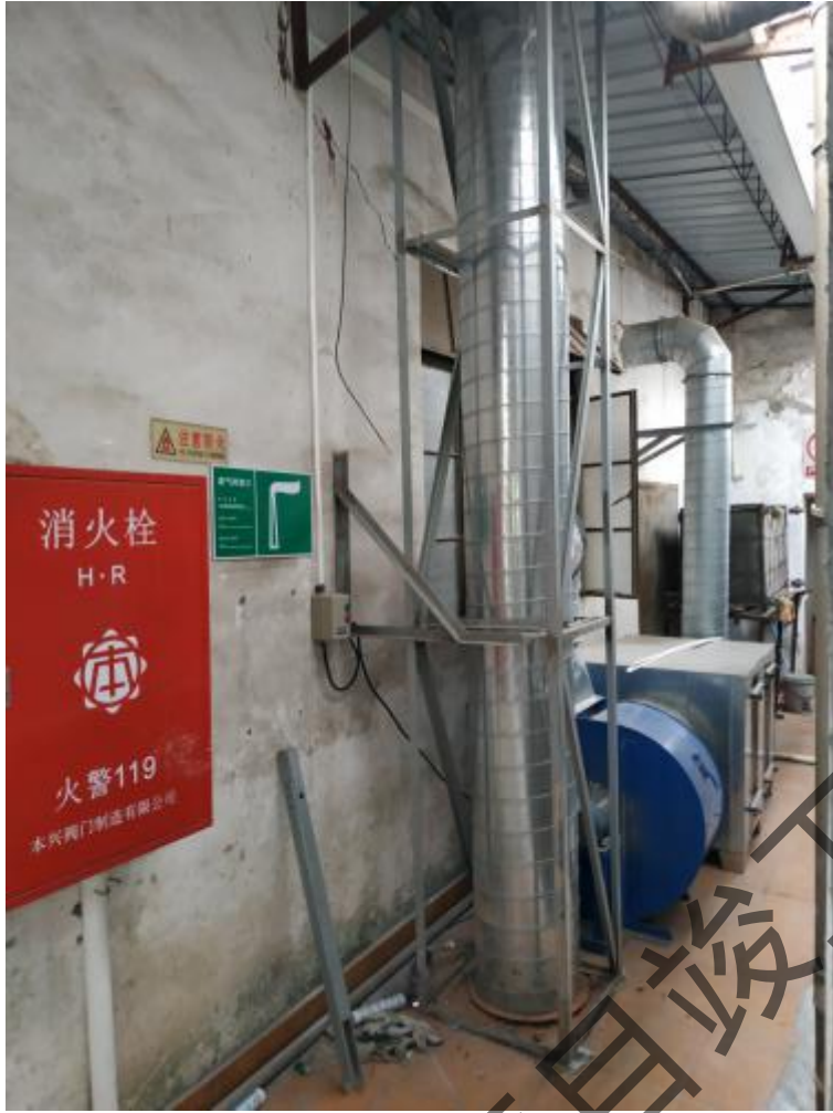
废气处理设施
