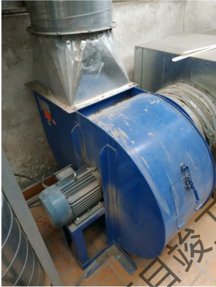
废气处理设施（风机）
