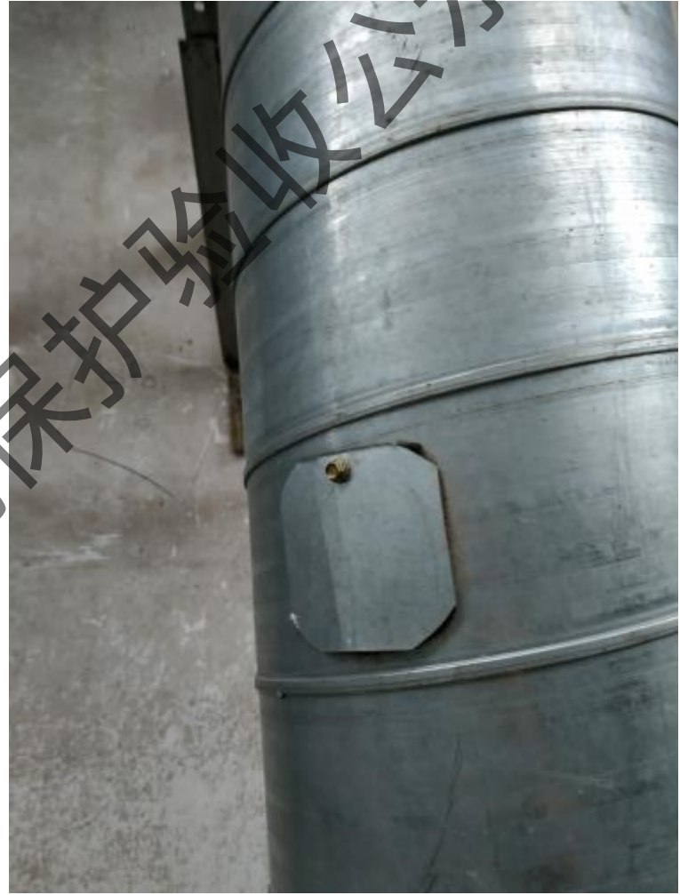
废气处理设施（采样口）
