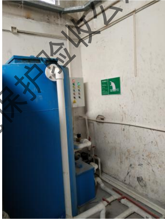
废水总排放口（水-01）远照
