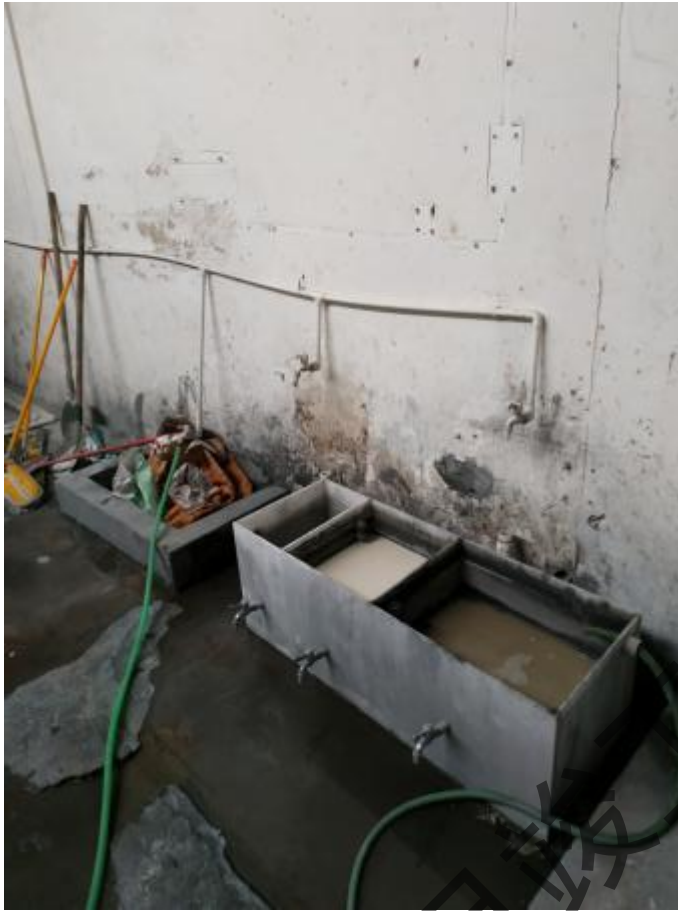
污水处理设施
