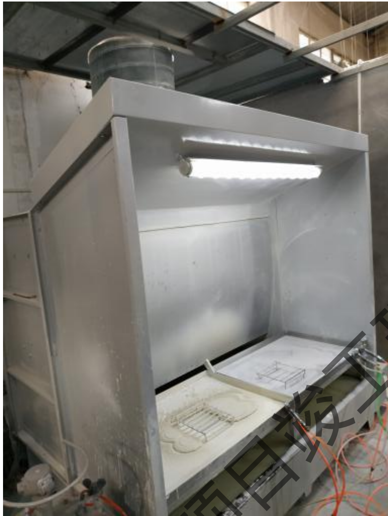
废气处理设施（水帘喷柜）
