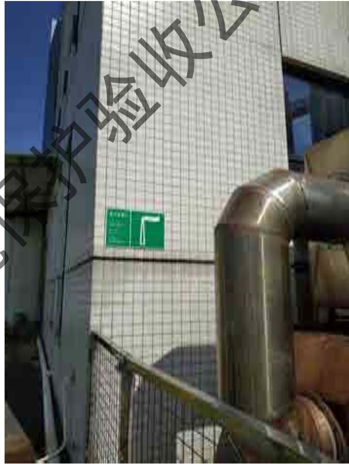
阻燃废气排放口（FQ-09）远照
