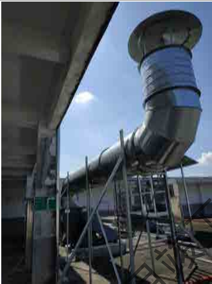
FQ-08 两级活性炭吸附装置
