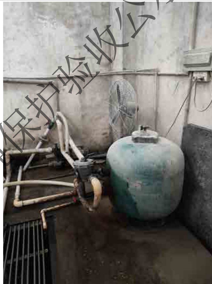
砂滤过滤设施
