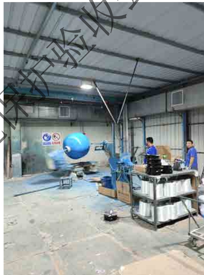
废气收集管道
