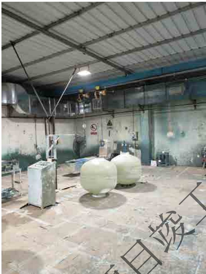
废气收集管道
