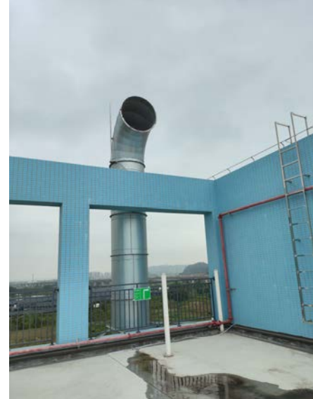
二层粉尘废气排放口 2 DA008 远照
