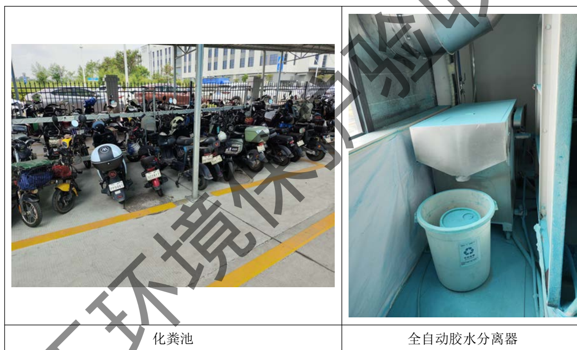
图 4.1-2 废水治理设施现场照片
