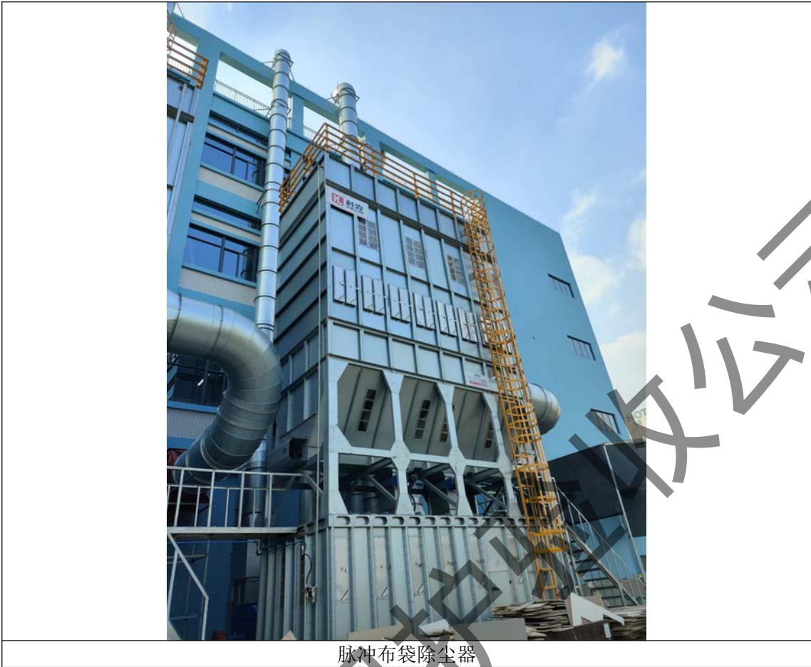
图 4.1-14 三层粉尘废气治理设施现场照片
