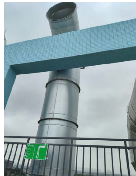
首层粉尘废气排放口 2 DA005 远照
