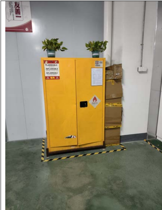
专用危险化学品贮存柜及地面防渗
