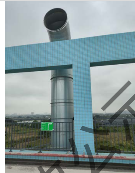
首层粉尘废气排放口 3 DA006 远照
