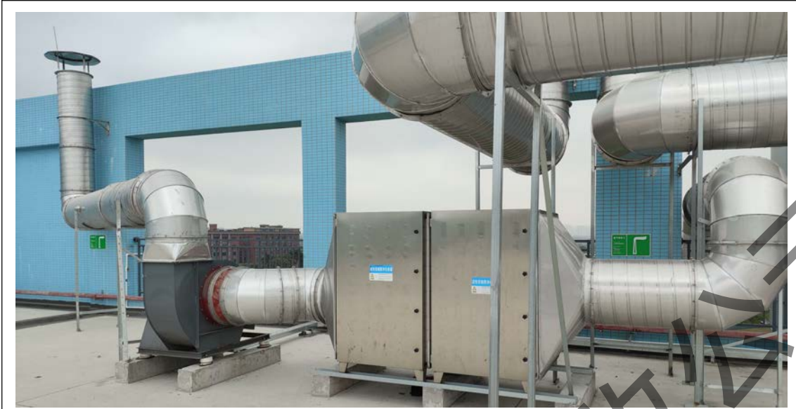
二级活性炭吸附装置及排气筒
