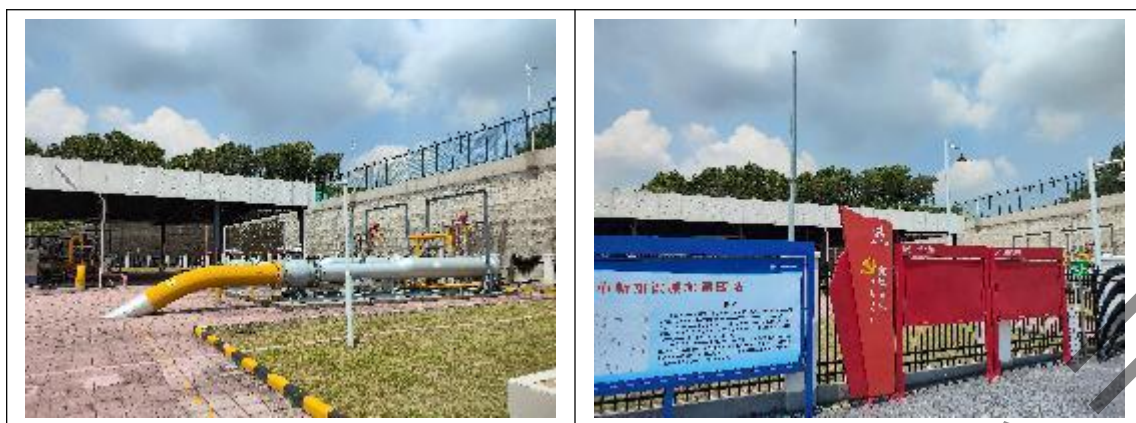
图 2.3.3-20 中新知识城北部调压站现场照片
