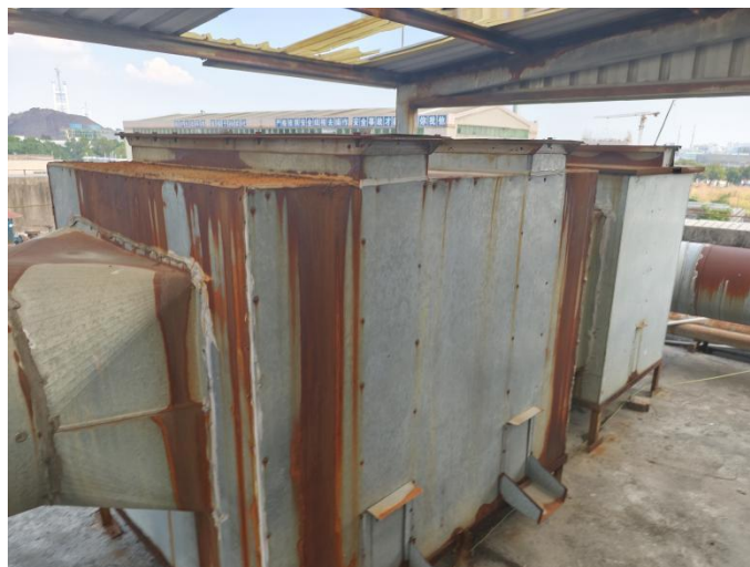
分析室废气处理装置（活性炭箱）
