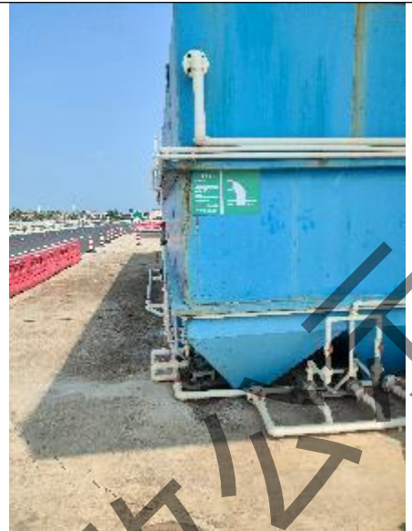
废水总排放口 DW001 远照
