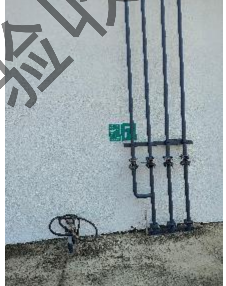
油气排放口 DA001 远照
