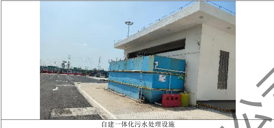
图 4.1-2 废水治理设施现场照片
