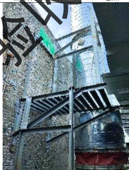
废气排放口 DA001 远照
