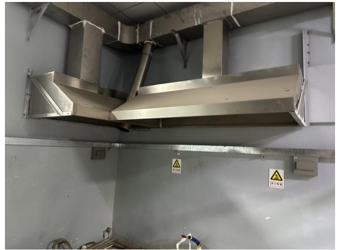
项目现场集气罩照片
