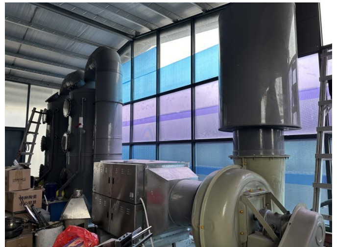
废气治理设施: 二级水喷淋(设除雾装置)+干式电除尘装置
